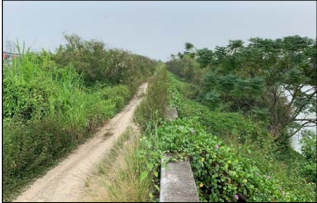
a. 高铁站南侧漠阳江堤防老旧破损
